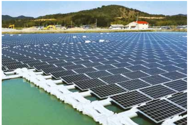
▲ Slika 3 Plavajoča sončna elektrarna v Franciji
